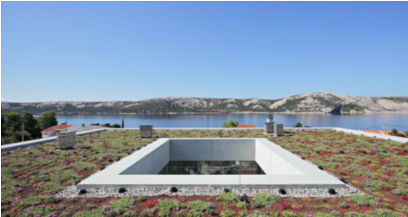
Azotea verde, más detalle de Sedum. Fuente: ídem https://architizer.com/projects/olive-house-1/
